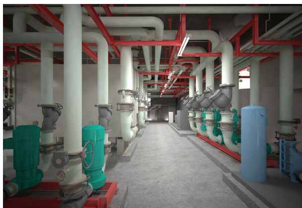
〈냉온수 순환 펌프 랜더링 View〉
